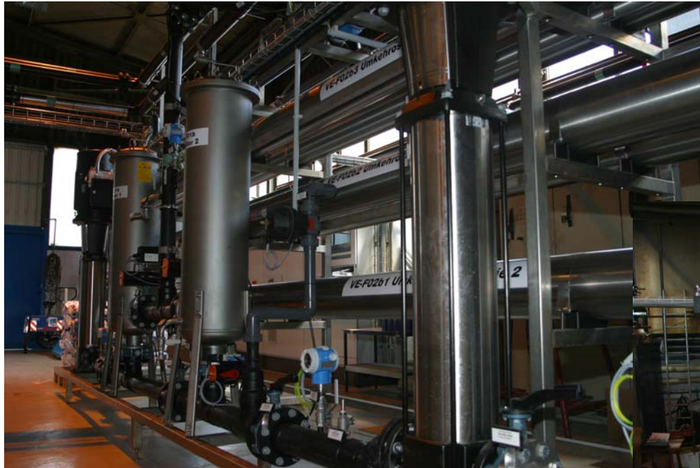
Druckrohre mit Feedpumpe und Vorfilter
